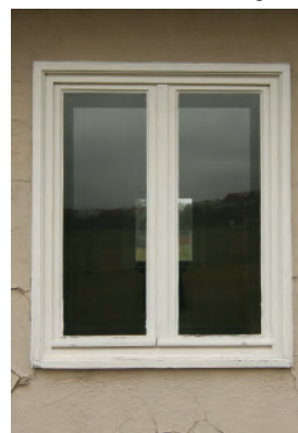
Raum 4, Kastendoppelfenster F 1.8 aussen.
