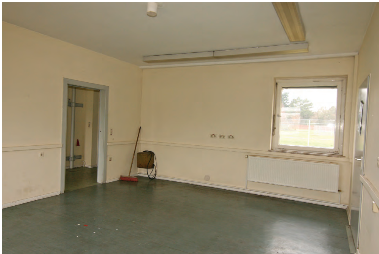
1. Erweiterung um 1972. Raum 2, Blick auf Fenster F 1.4, links Tür TI 1.2, rechts TI 1.1.
