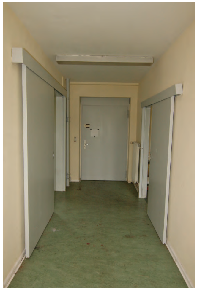
1. Erweiterung um 1972, Raum 3, Blick auf Eingang TA 2. Rechts und links Schiebetüren TI 1.2 und TI 1.3.
